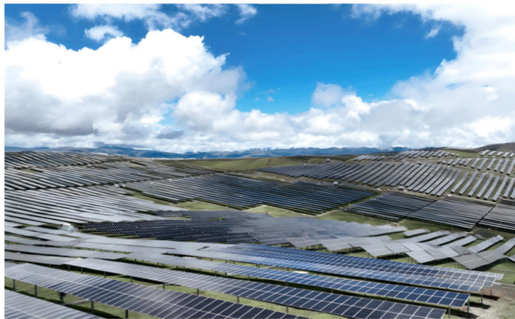
四川省甘孜州的柯拉一期光伏电站
