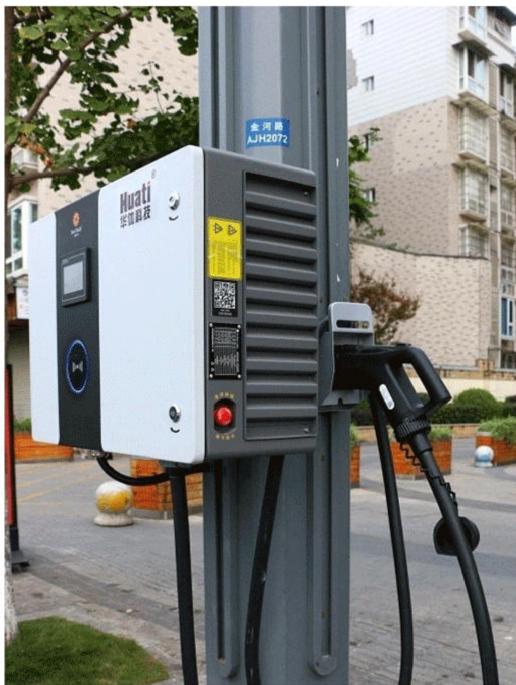
双流金河路“智慧路灯+充电桩”
